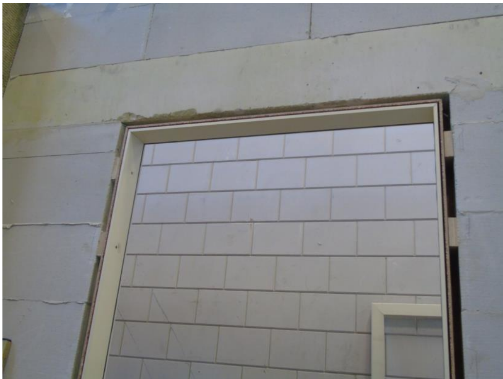
Foto C.2 : kozijn rechter deur in wand
