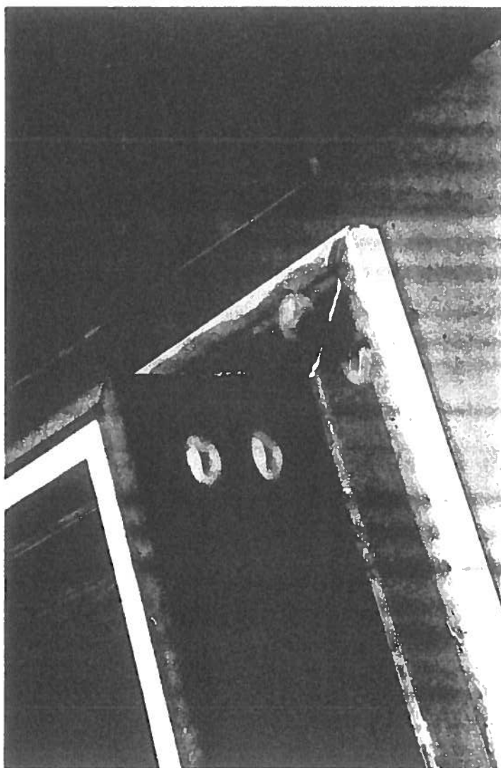
Foto 1: Hoekpunt van het kozijn
